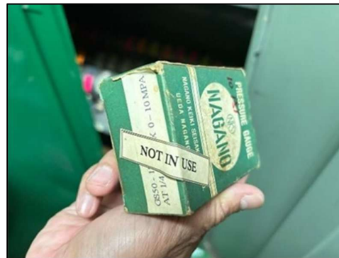
Gambar 4. Label Not in Use pada Pressure Gauge
