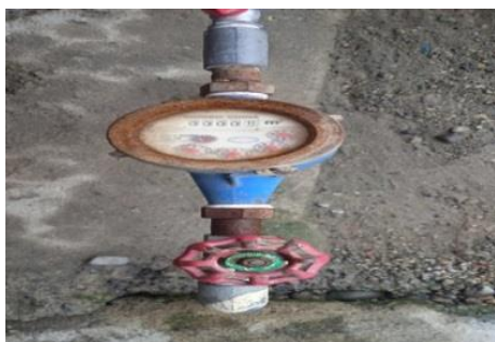
Gambar 2. Meteran SR yang tidak berfungsi
