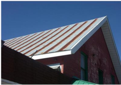
Gambar 2. Korosi Atmosferik pada Atap Rumah (Sumber:Google)
