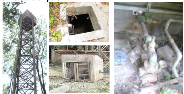
Gambar 7. Kondisi komponen utilitas
