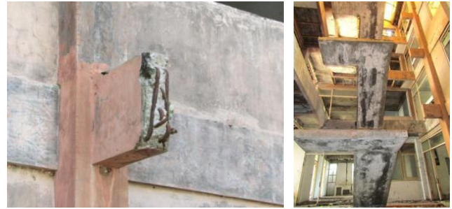
Gambar 5. Kondisi komponen struktur
